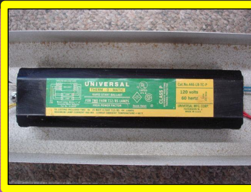
MNo3- PCB Ballast
